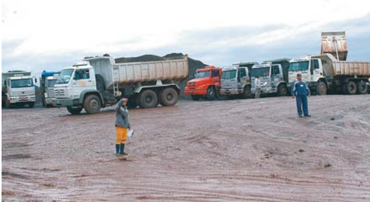
FILA de caminhões se concentrou no início da manhã de ontem na britadeira em Linha Cinco, para carga e descarga
